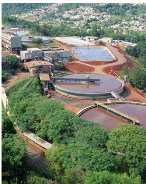
ETE da fábrica integrada da Klabin em Telêmaco Borba
